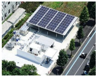
グリーン水素活用施設 ©東芝エネルギーシステムズ (株)
