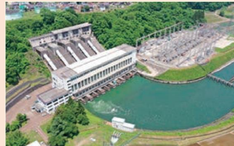
信濃川水力発電所
