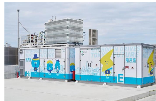
(水素室・電気室)
