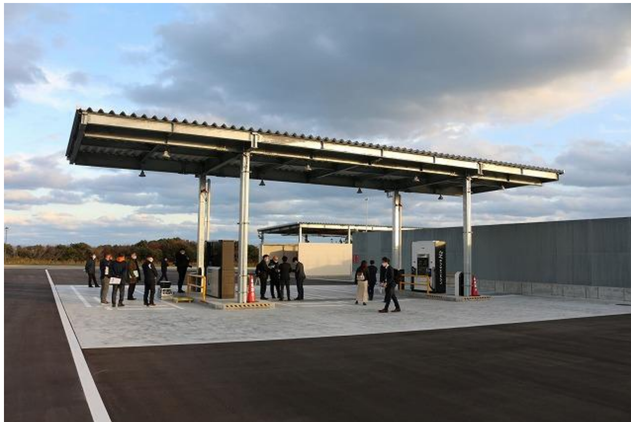
福島水素充填技術研究センターの水素充填施設
