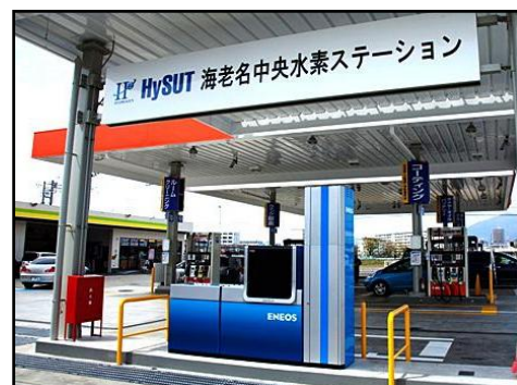
日本初のガソリンスタンド併設 水素ステーションの設計・施工
